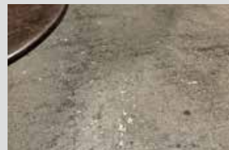
椅子の引きずりによる剥がれ
